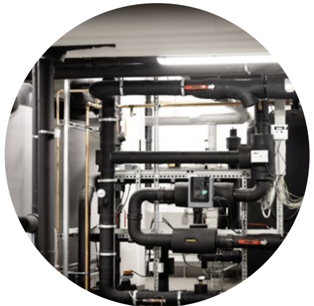
Im Neubau Durlacher Straße/ Steigenhohlstraße erzeugen innovative Energietechnologien klimafreundliche Energie.
