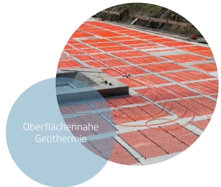
Oberflächennahe Geothermie ist ein wesentlicher Bestandteil unseres ambitionierten „Green Energy-Konzepts“ im Neubau.
